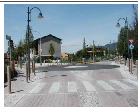
Le deformazioni della carreggiata possono interessare parti estese di incroci. Nell'esempio una rotonda completamente sormontabile da veicoli in specifiche condizioni di transito (es. trasporti speciali).
